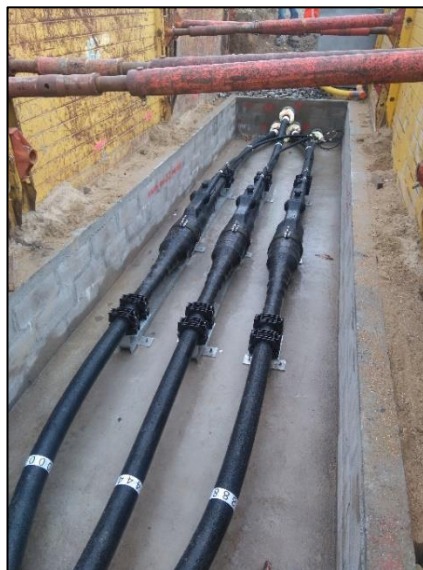
Figure 50 : jonctions installées dans une chambre de jonctions
