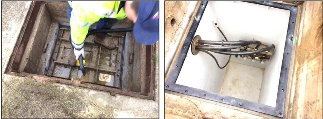
Figure 51 : Puits de permutation
